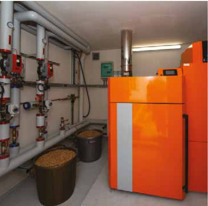
Chaufferie bois granulés - Mairie de Saint-Cyr-en-Talmondais.
