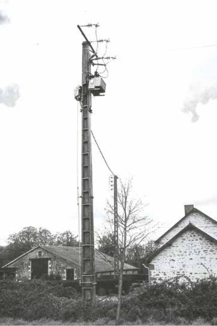
Un poste de transformation H61, surnommé « Croix de Jésus ».
