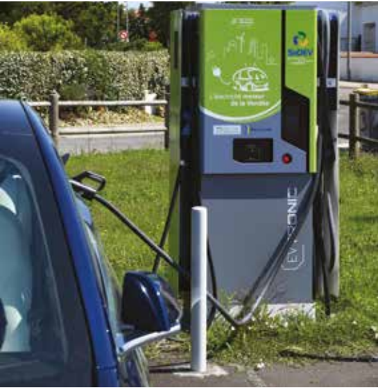
Recharge d'un véhicule électrique à une borne rapide à La Barre-de-Monts.
